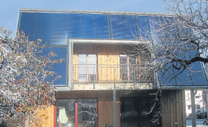
Die Solarkollektoren heizen die 7.000 Liter Wasser auf, die sich in einem Wassertank im Haus befinden. Foto: Wilhelm
