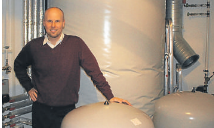
Das Wasser aus dem Tank fließt dann durch die Wände und sorgt für wohlige Wärme im Haus. Foto: Bengler
